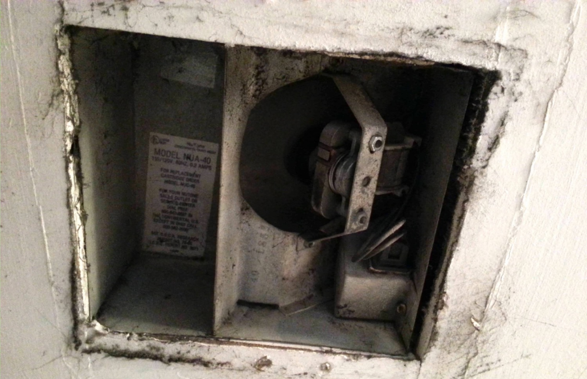
Bathroom Exhaust Fan Mold
